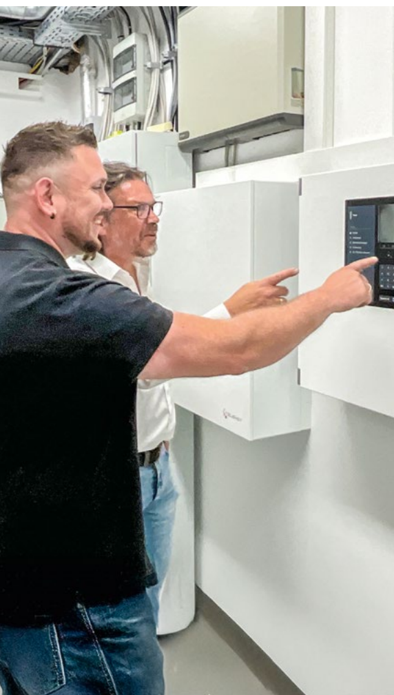
Norman Groten von Limbach Secur (links) und Stefan Metzroth von Telenot an der neuen Brandmelderzentrale hifire 4400.
