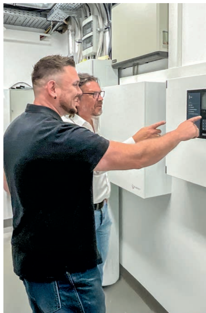
Norman Groten von Limbach Secur (links) und Stefan Metzroth von Telenot an der neuen Brandmelderzentrale hifire 4400.
